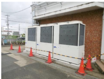
大型室外機（合計7機）
