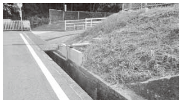
紀泉台パンダ公園の湧水処理設備
