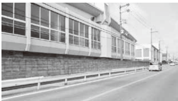
根来小学校北側のブロック塀
