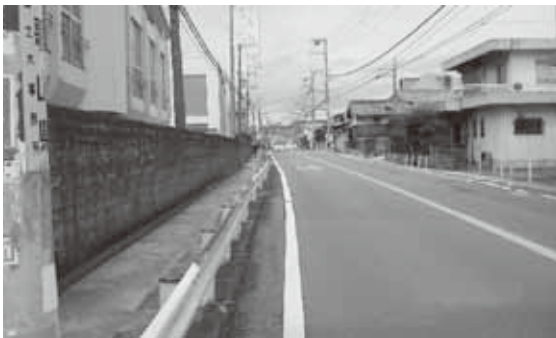
根来小学校の北側ブロック塀
