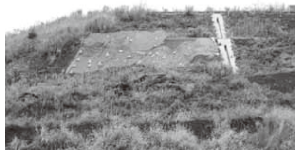
京奈和道の法面 崩壊
