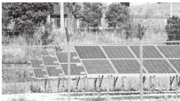
設置されたソーラーパネル
