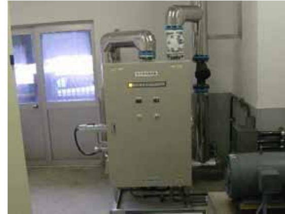
写真1 紫外線処理装置の設置例
