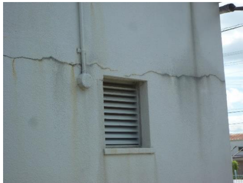
山崎小学校（一部ひび割れ）
