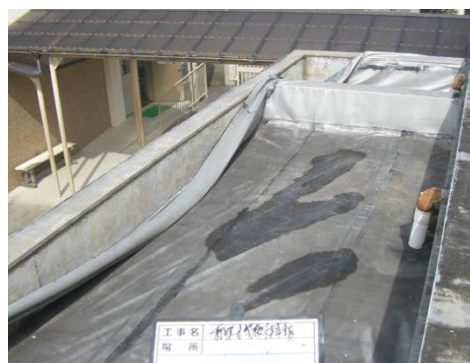
根来小学校（ゴムシート防水の破損）
