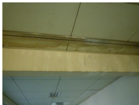
岩出第二中学校（雨漏れ痕）
