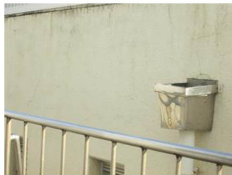
上岩出小学校（汚れ）
