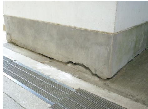
岩出第二中学校（ひび割れ）
