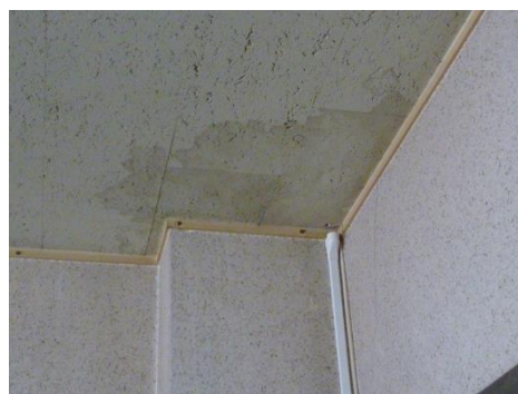
根来小学校（雨漏れ痕）
