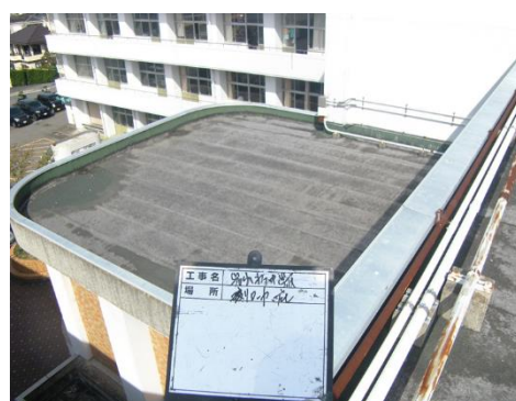
岩出第二中学校（排水不良）
