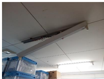
岩出市中央公民館 (内部仕上：破損)
