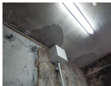
根来地区公民館 (内部仕上：雨漏れ痕)
