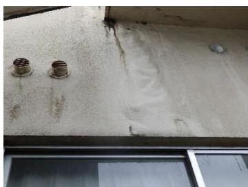
山崎地区公民館 (外壁：膨れ)
