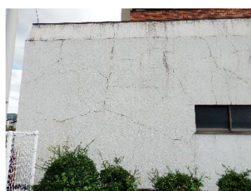
上岩出地区公民館 (外壁：ひび割れ)
