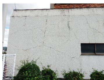
上岩出地区公民館 (外壁：ひび割れ)
