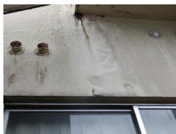
山崎地区公民館 (外壁：膨れ)
