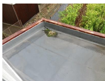
岩出市立体育館 (屋上：排水不良)
