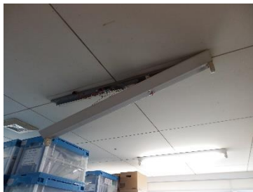
岩出市中央公民館 (内部仕上：破損)
