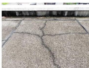
紀泉台地区公民館 (屋上：ひび割れ)
