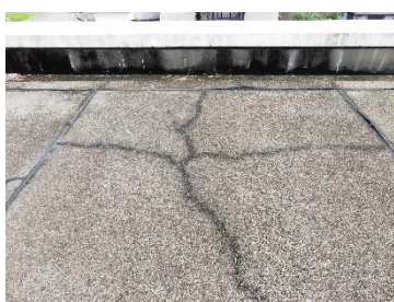
紀泉台地区公民館 (屋上：ひび割れ)
