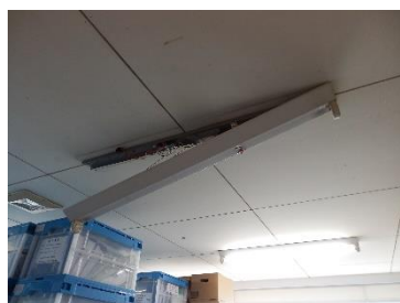
岩出市中央公民館 (内部仕上：破損)
