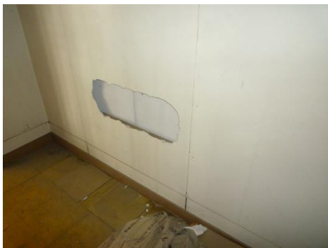
山崎小学校（ボードの破損）
