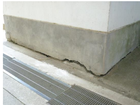
岩出第二中学校（ひび割れ）
