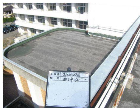
岩出第二中学校（排水不良）
