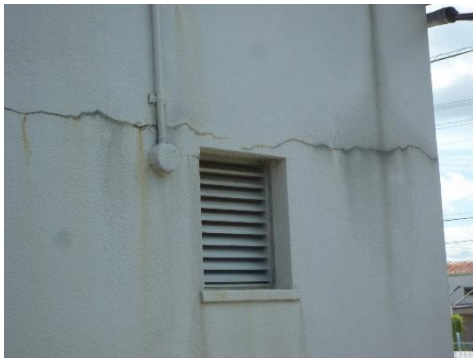
山崎小学校（一部ひび割れ）
