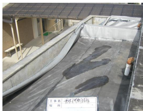
根来小学校（ゴムシート防水の破損）
