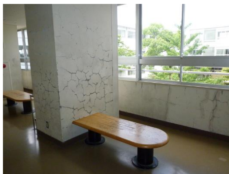
岩出第二中学校（損傷）
