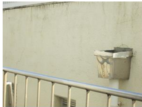
上岩出小学校（汚れ）
